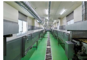
長さ約90メートルの蒸しライン
